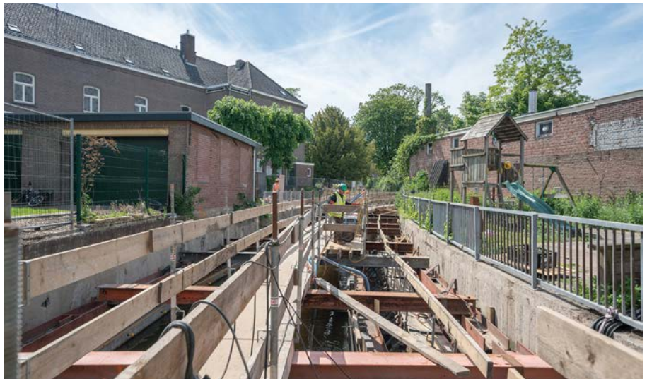
Bij de herinrichting van de Watermolenbeek in Roosendaal is gebruik gemaakt van een opmerkelijke bekistingoplossing.
